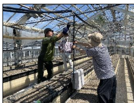
図6 幡多農業高校メロンハウスに設置
